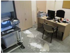
TR5 Reparació de goteres. A diversos edificis del campus. PIU
