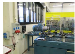
TR4 Lab. de Fluids Instal·lació de grups hidràulics.
