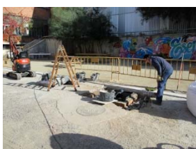
TR45 Arqueta per regular el cabal dels pluvials.
