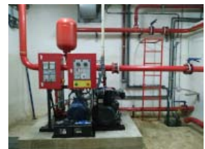
TR4 Nova instal·lació grup contra incendis.
