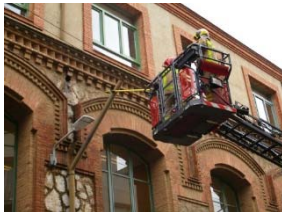
TR1 Despreniment d'un baixant exterior.
